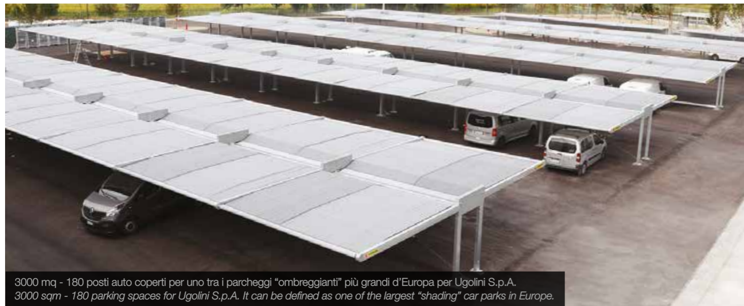
Zari Srl - area di sosta auto coperta con coperture per parcheggi K-Shelt Zari Srl - covered parking area with K-Shelt car park covers
